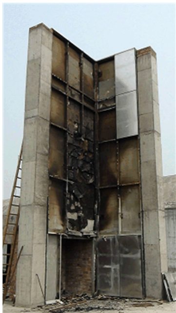
图 12 薄抹灰幕墙保温系统的损坏状态
